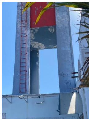
Reservatório com presença de infiltração.
