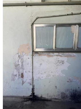
Destacamento de pintura.
