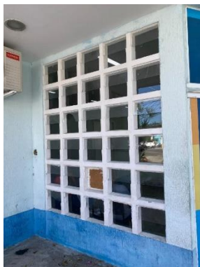
Ausência de vidro.
