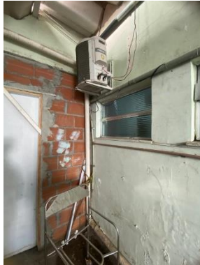
Falta de revestimento em paredes.
