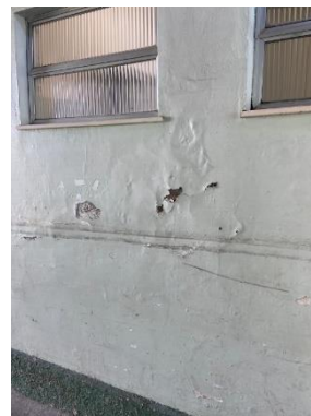
Destacamento de revestimento.
