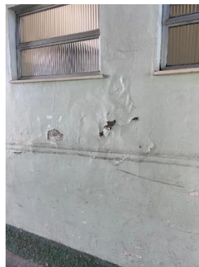
Destacamento de revestimento.
