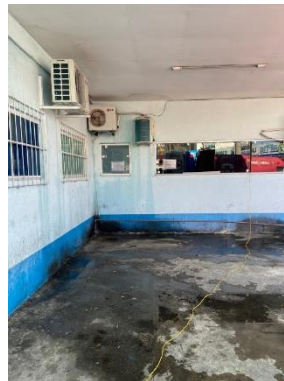
Presença de infiltração e mofo por ausência de drenagem de aparelhos de refrigeração.
