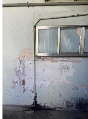
Destacamento de pintura.
